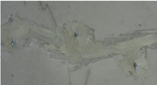
Rys. 1. Iniektory wiercone umieszczone wokół pęknięcia i uszczelnione odpowiednim klejem epoksydowym z serii MasterBrace.
